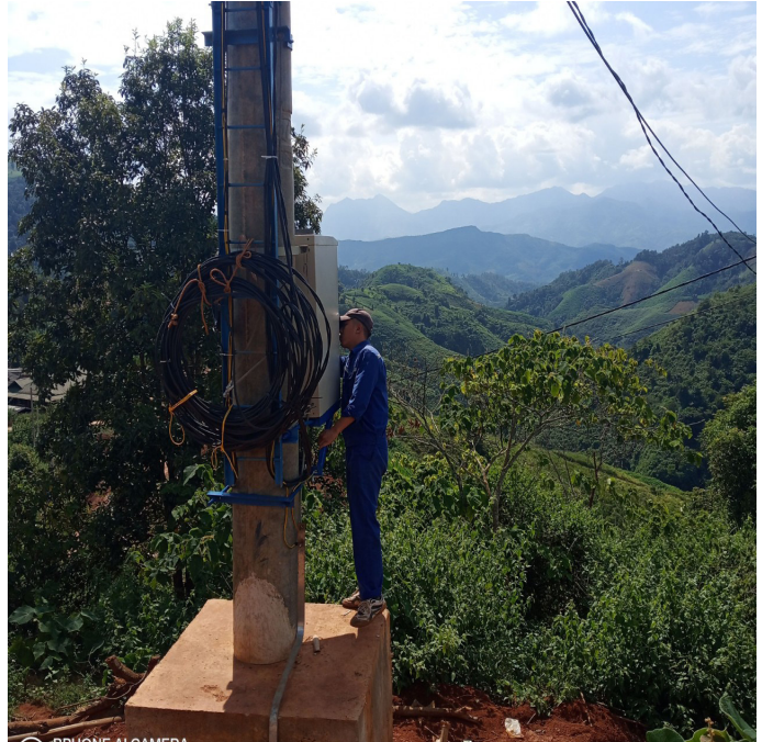
Trạm phát sóng thông tin di động được lắp đặt tại xã Huổi Léch, huyện Mường Nhé phục vụ nhu cầu thông tin liên lạc, giải trí của người dân.
